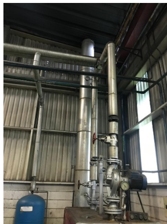
Fotografía 8. Ducto del calderín
