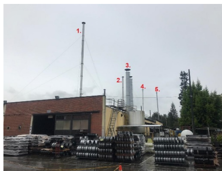
Fotografía 6. Ductos: 1. Horno de acabados, 2. Horno de polimerizado, 3. Cabina de pintura, 4. Horno de deshumectación, 5. Calderín
