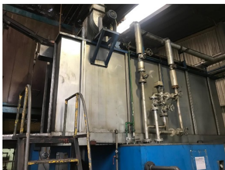
Fotografía 5. Horno de deshumectación
