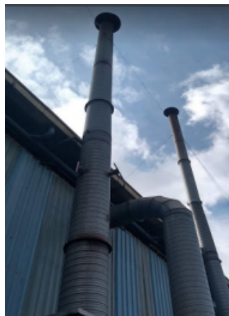
Fotografía 11. Ducto del área de soldadura
