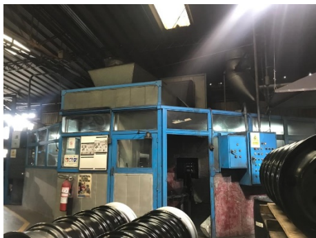
Fotografía 9. Cabina de pintura
